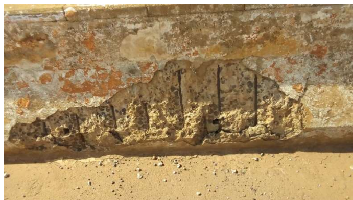
Figura 5: Perda de cobrimento e exposição da armadura.
