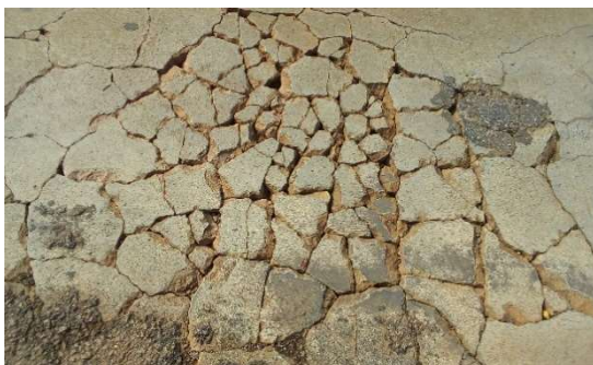
Figura 4: Fissuras e trincas.
